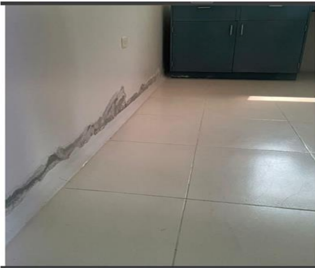
Fotografía No. 9 Humedades Laboratorio de aguas
