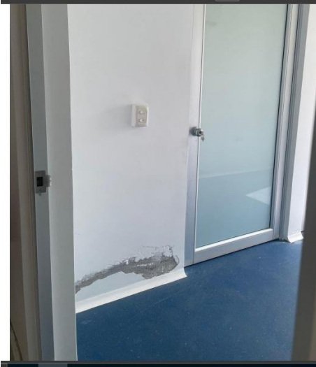
Fotografía No. 8 Humedades Laboratorio de aguas
